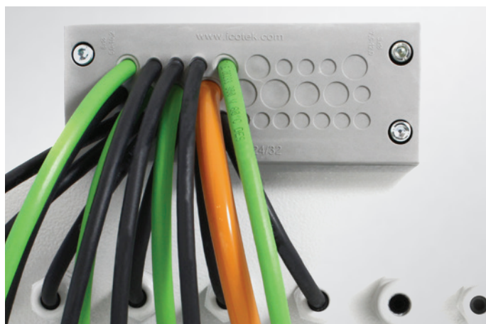
Alta densidad de cableado
